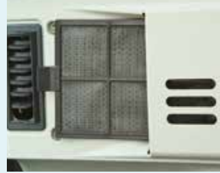
Filtro del aire acondicionado
