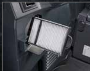
Filtre à air extérieur de climatisation
